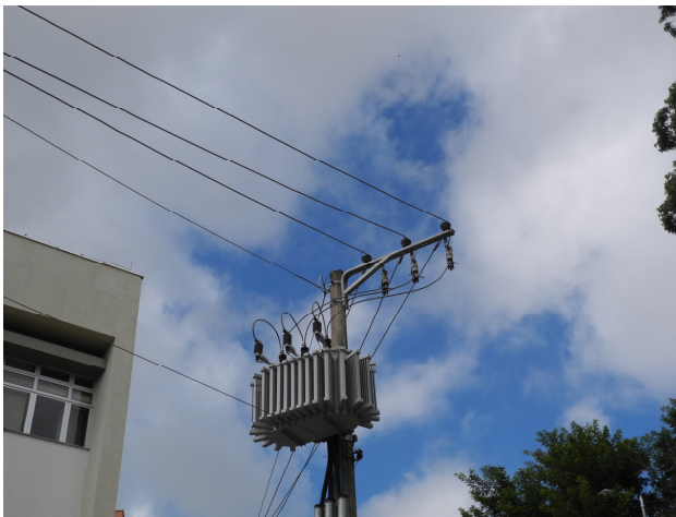
Fig. 9.6.1 Fiação numa rua brasileira com fornecimento de energia elétrica com o sistema trifásico.
